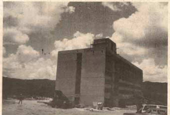
Proceso de construcción del edificio de vivienda para envejecientes Cristo Rey en Caguas, P.R.
